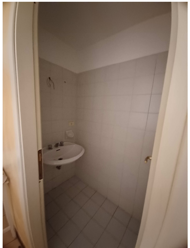
Locale bagno (secondo livello)
